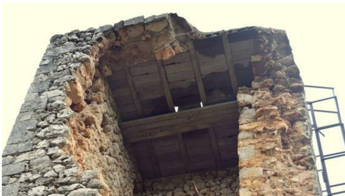
Detalle del torreón derrumbado. / L. A. CURIEL
